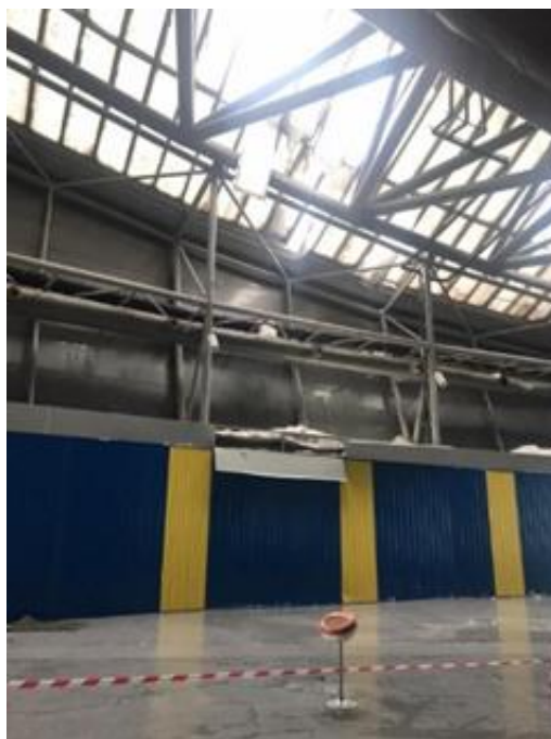
Рисунок 3 - Обрушение крыши на спортивном стадионе «Астана-Арена»
