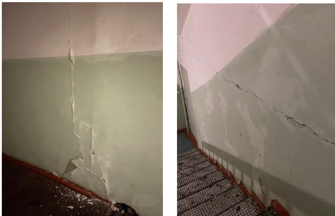
Рисунок 14 – Повреждения в зданиях после землетрясения
