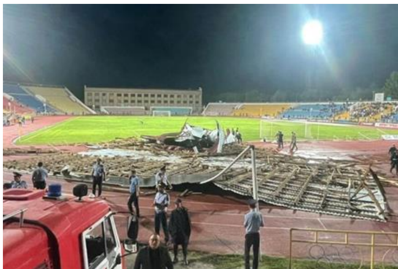
Рисунок 4 - Обрушение крыши здания Центрального стадиона, г.Шымкент
